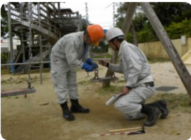
コンビネーション遊具の劣化状況や腐食状況を点検する屋良朝男職員(写真右)と大城聡職員
